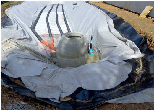
Abb. 7: Versickerungsbecken (TDC ZT-GmbH)
