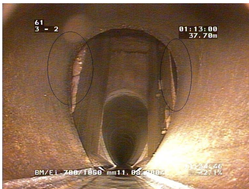
Abbildung 8: Schächtwände ragen in das Ei-Profil (Anm.: Kameraposition zu tief)
