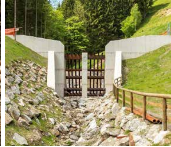
Abb. 4: Die Sperrenbauwerke filtern Wildholz, bremsen die ab rinnenden Wassermassen und schützen das Gemeindegebiet. © Gemeinde Gasen
